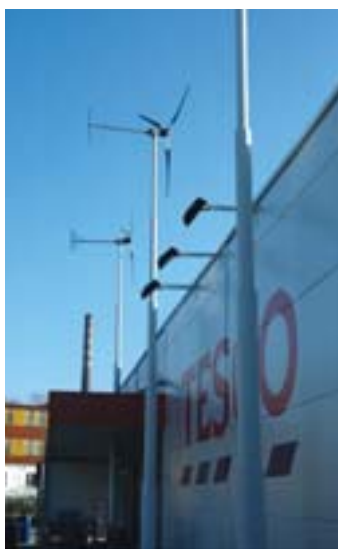
Widok instalacji wiatrowych zainstalowanych na markecie Tesco w Zdziezowicach
