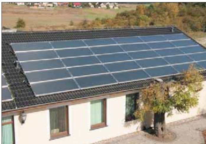
Solary na dachu budynku w Kamieniu Śląskim
