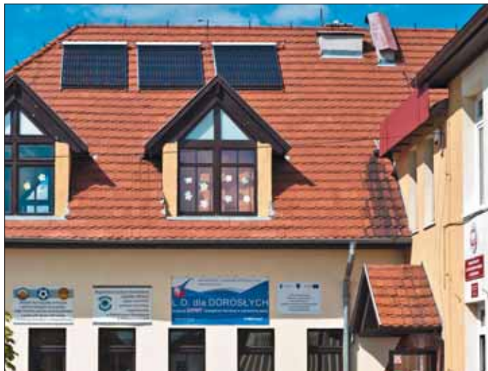
Kolektory słoneczne na dachu budynku Publicznego Gimnazjum w Komprachcicach
